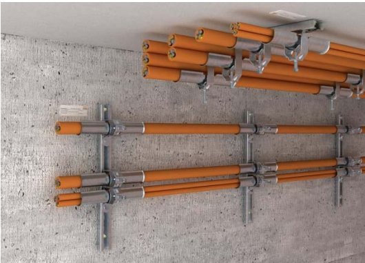
Installazione con staffa reggicavo e coppa longitudinale
